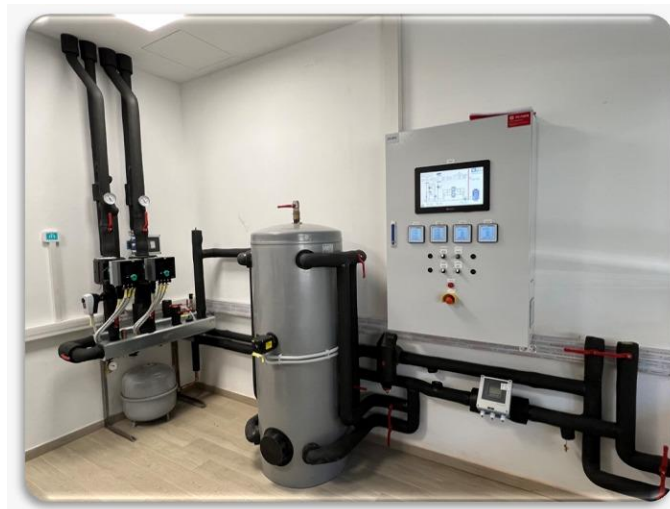
Şekil 10: FSB üzerinde hava/su ısı pompası ile laboratuvar tesisatı
