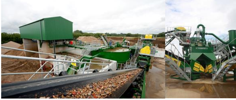
Şekil 5. CDE Global makinelerinden oluşan komple geri dönüşüm hattı
